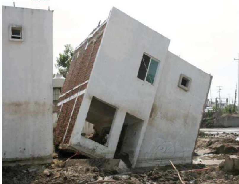
Fotografía 11. Hundimiento de vivienda en Barrio IV.
